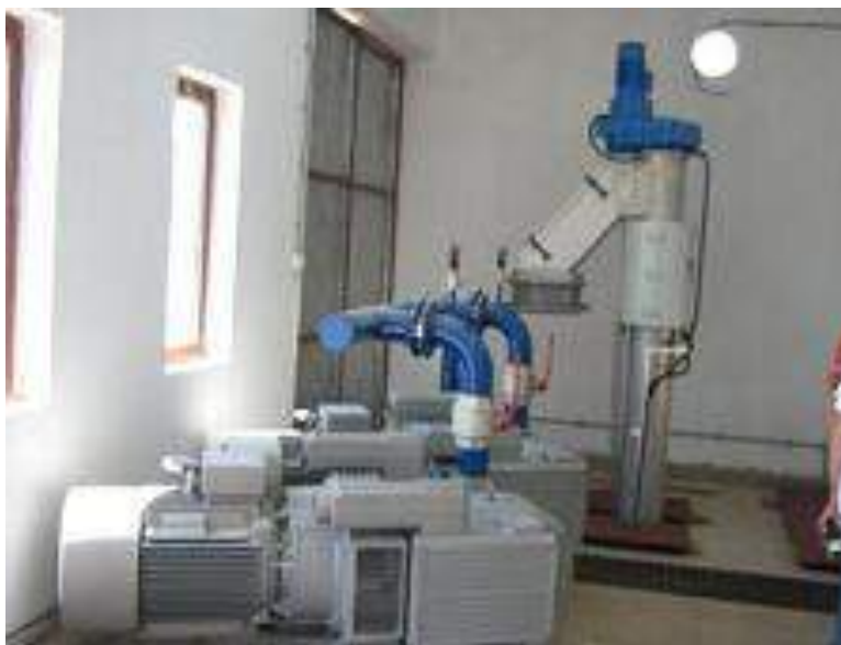
Slika 2.2.-5. Pužno sito, kompresori.
